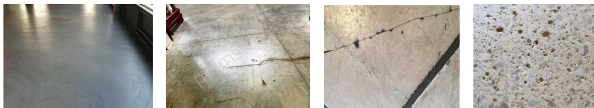
Fig. 23. Fisuri, crăpături, pori și denivelări ale pardoselilor de mozaic
